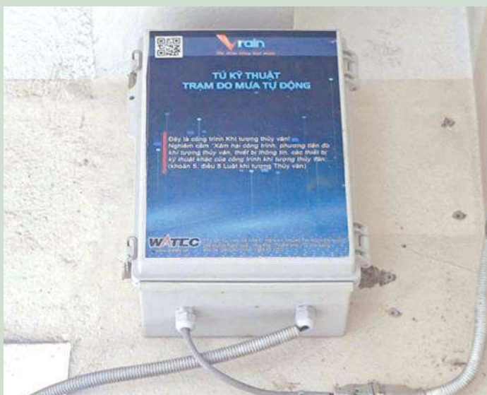
Thiết bị và Tủ kỹ thuật - Trạm đo mưa tự động có kết nối về Trung tâm điều hành
